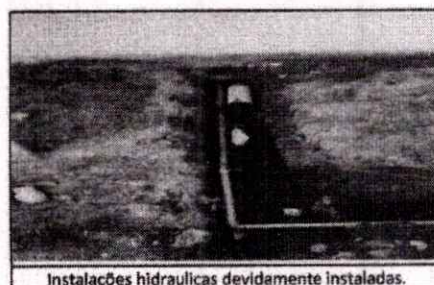
Instalações hidráulicas devidamente instaladas.
