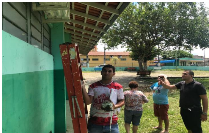
Figura 37 - Instalação de aparelhos de ar condicionado – Escola Municipal São Francisco
