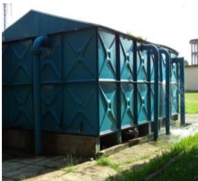
Imagem 98 - Reservatórios de água do SAAE
